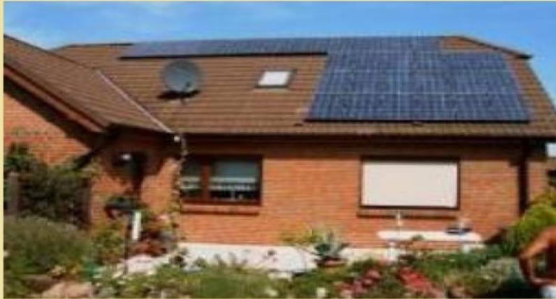
Mit der Sonne Geld verdienen! Eine Solaranlage auf dem Dach eines Einfamilienhauses in Ribnitz-Damgarten. Foto: Eckart Kreitlow
